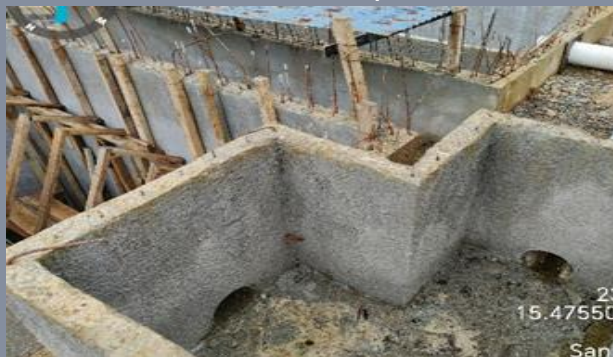
Caja distribuidora de caudales
