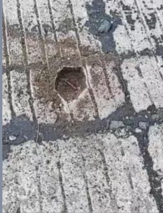
Problemas en el asfalto.
