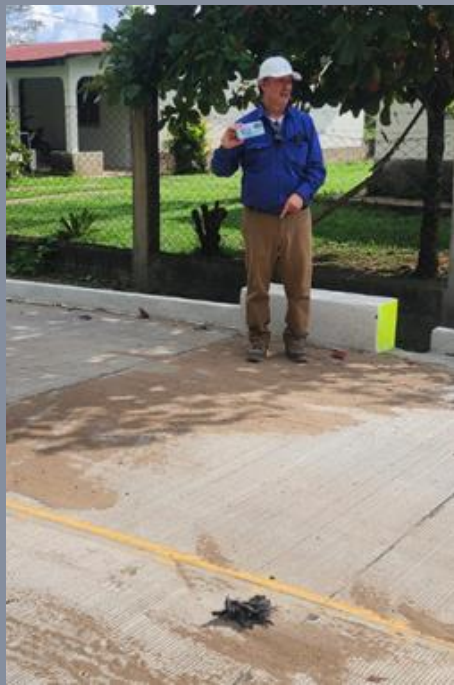
Vista de acumulación de sedimentos por las lluvias recientes lo cual ocasiona peligro para los usuarios.
