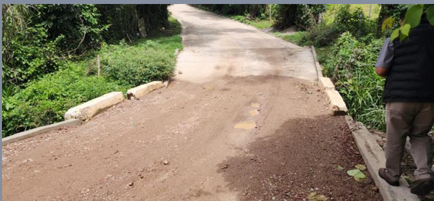
Vista de proyecto concluido, y problema de arrastre sedimentos por falta de cuneta para desfogar a quebrada.
