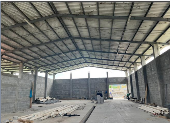
Vista interior de la infraestructura para clasificación de desechos sólidos
