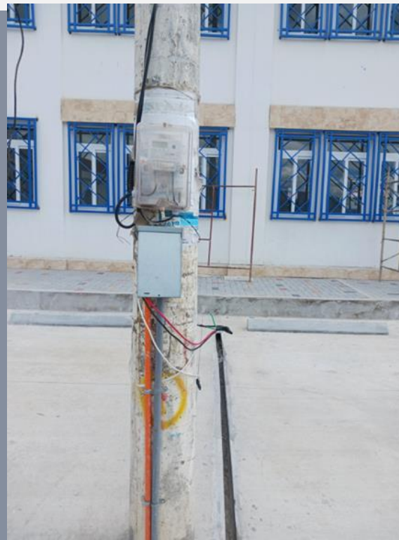
Vista acometida eléctrica.
