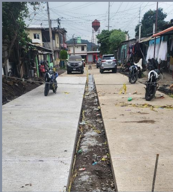
Vista de las jardineras que se van a llenar por lo estrecho de dejar un carro estacionado a los lados.
