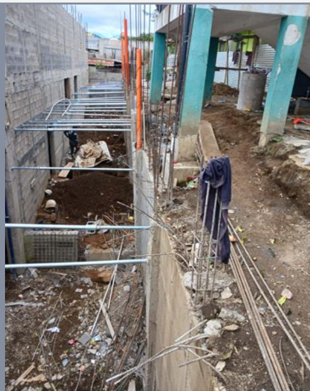
Vista de muro colapsado.
