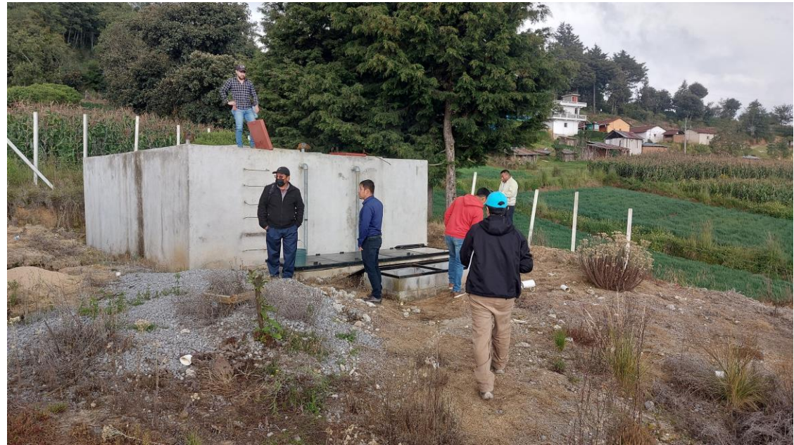
Sistema de agua, San Carlos Sija, Quetzaltenango
