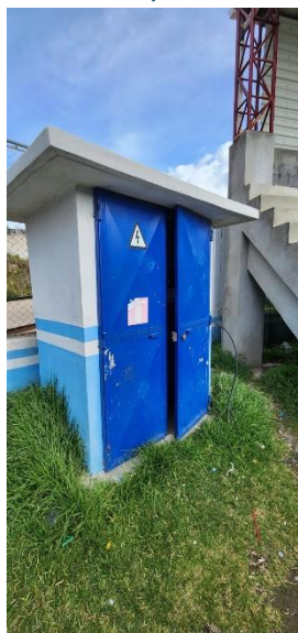
Cuarto eléctrico abierto exponiendo alto voltaje al público.
