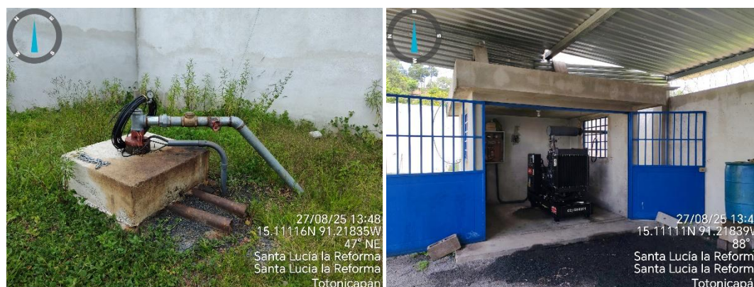
Pozo mecánico, caseta de bombeo y planta generadora eléctrica.
