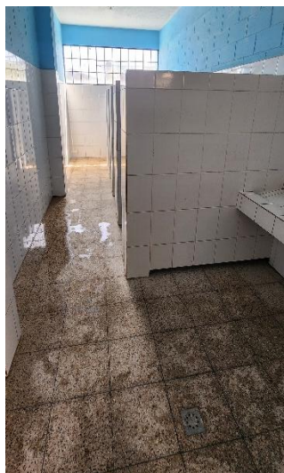
Los servicios sanitarios del segundo nivel donde no hay un drenaje y se empoza el agua.
