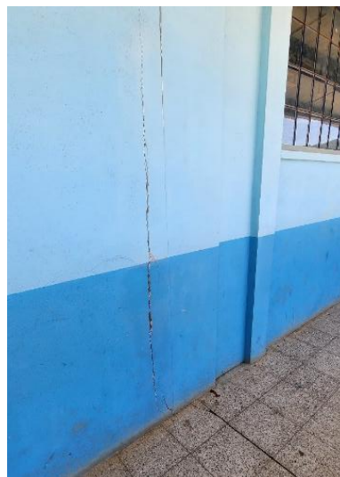
Fisuras notables en los muros y el piso del segundo nivel.
