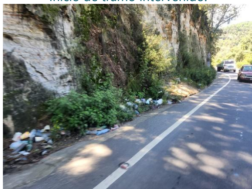
Cunetas obstruidas por desechos en la vía pública.
