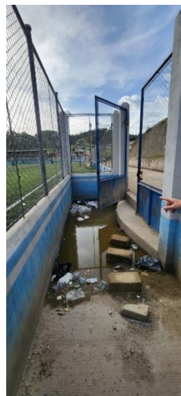
Una de las entradas inundada sin drenaje.
