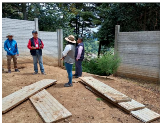
Muro perimetral colapsado.
