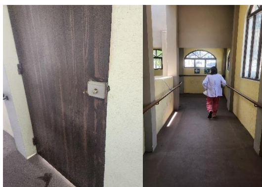
Puerta sellada y rampa extensa.
