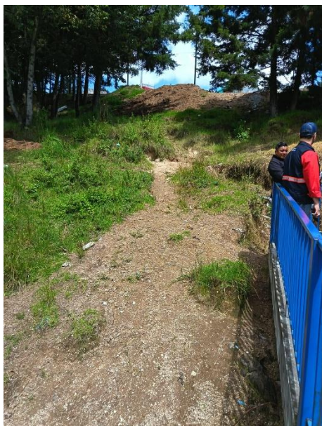
Área externa, con las lluvias presenta deslizamientos y socavamientos provocando obstrucción de drenajes e ingreso de escorrentía a escuela.
