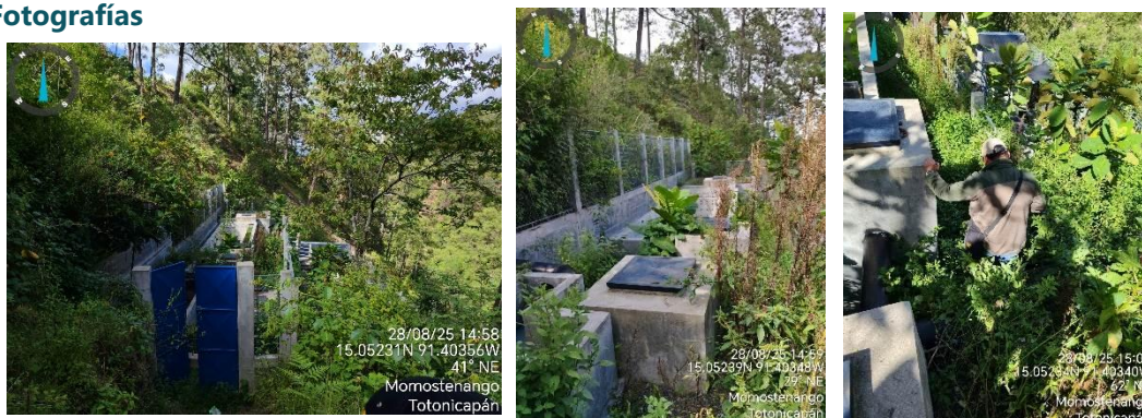
Vista general ingreso a planta y cajas trampa de grasa-desarenador.
