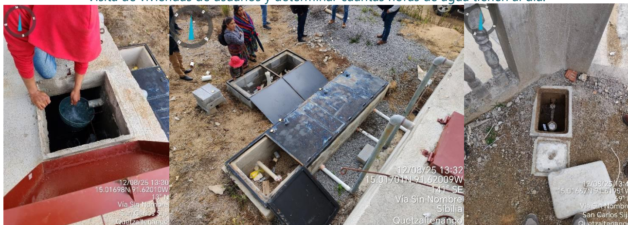
Aforo en tanque, cajas de válvulas e hipoclorador y contador de agua en conexión predial
