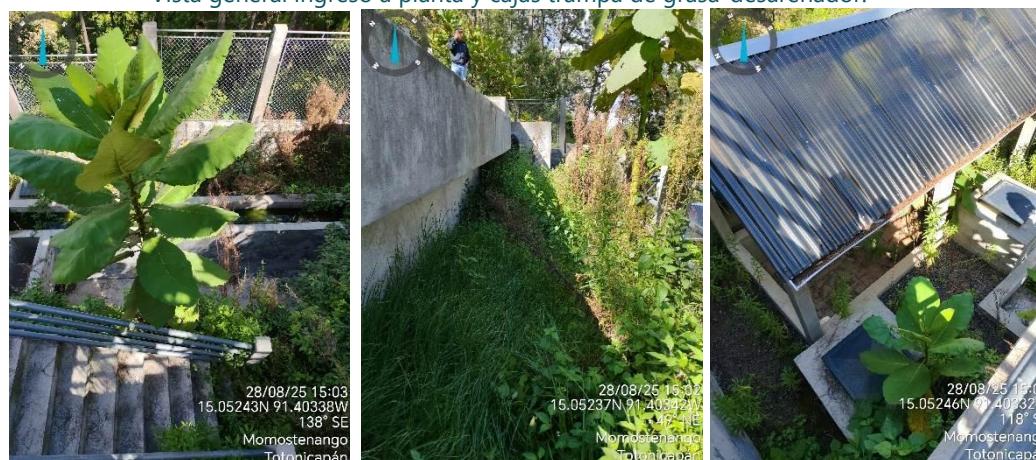
Acceso a sedimentador 2, vista lateral sedimentador 1 y patio secado de lodos.
