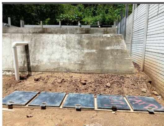
Cajas de válvulas de distribución del sistema.
