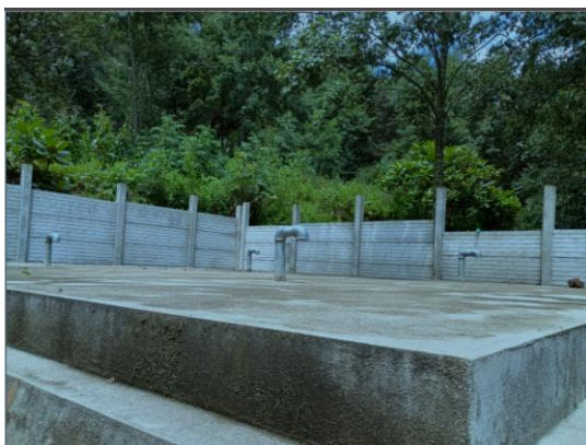
Tanque de distribución de agua.
