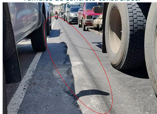
Deformaciones plásticas carpeta asfáltica.
