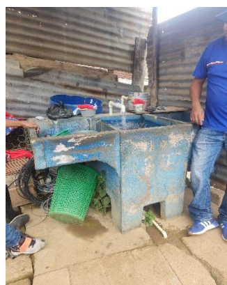
Se identifican dos chorros, sin embargo, uno viene del tanque de almacenamiento y otro directo del sistema.
