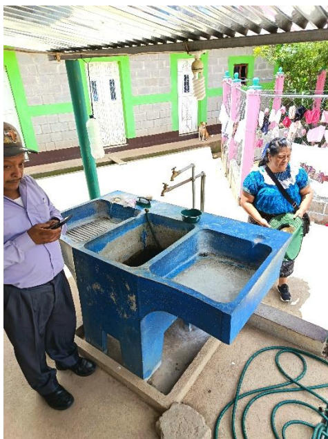
Verificación del servicio con beneficiarios (no hay agua).
