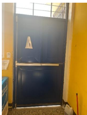
Puerta de ingreso, con desperfectos.
