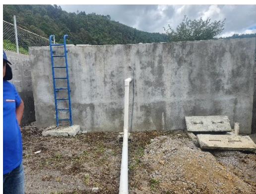
Tanque de agua.
