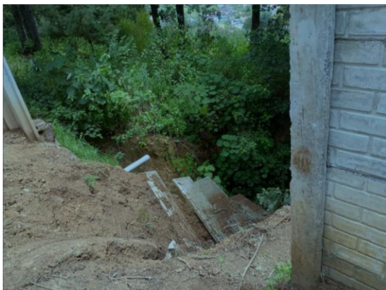
Muro perimetral colapsado en uno de sus costados.
