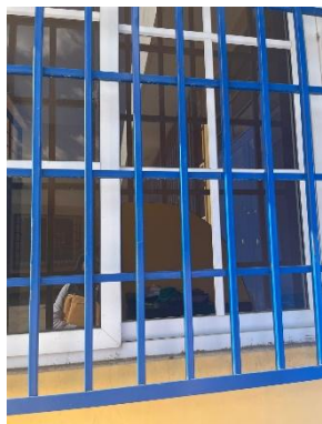
Ventana rota, por vandalismo.
