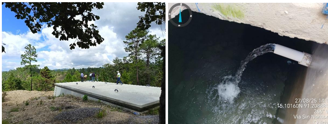
Tanque de almacenamiento de concreto ciclópeo e ingreso de caudal de bombeo.
