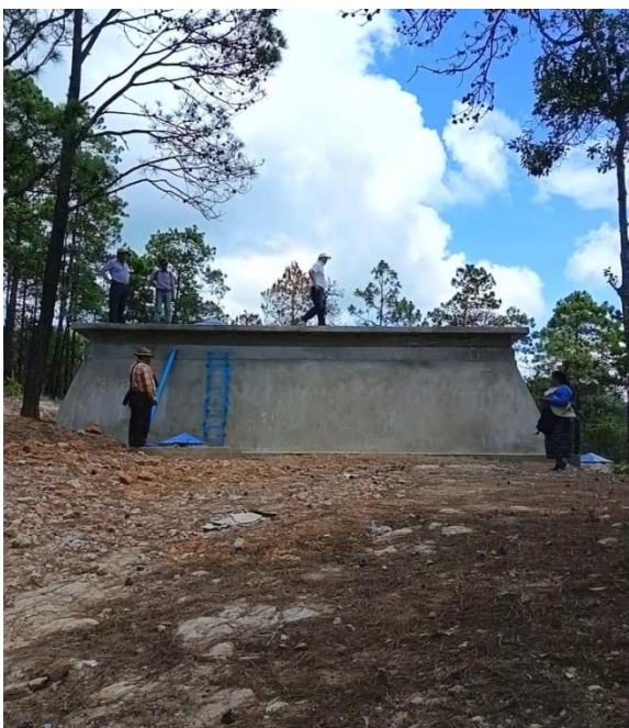
Tanque del almacenamiento de agua.
