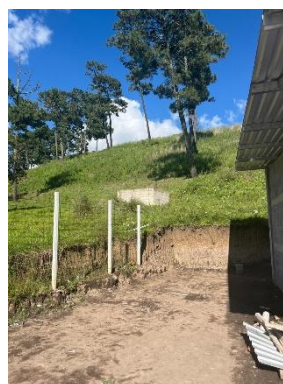
Perimetro del proyecto sin muro perimetral.
