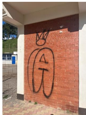
Paredes manchadas por vandalismo.
