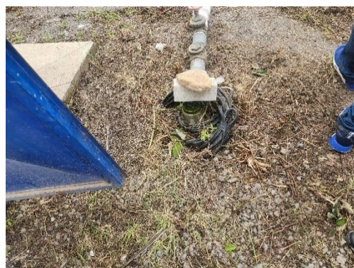
Ubicación de pozo mecánico.
