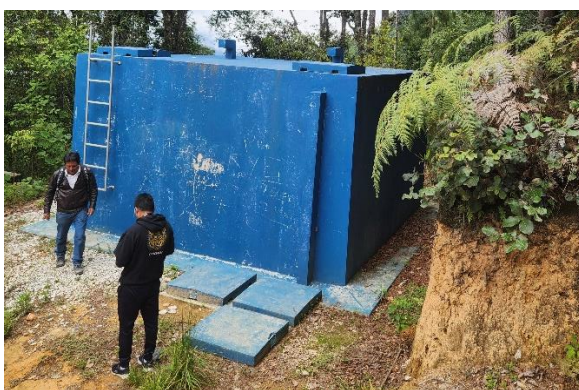
Tanque de distribución.
