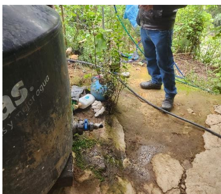
Tinacos de usuarios, para aprovisionamiento de agua.
