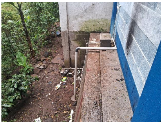
Evidencia de humedad afuera de la construcción.
