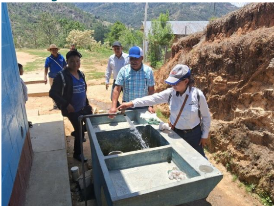
Grifo instalado en la escuela de primaria.
