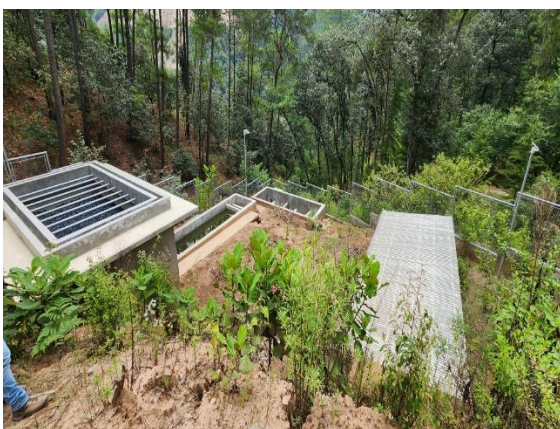
Vista del filtro percolador y sedimentador secundario.
