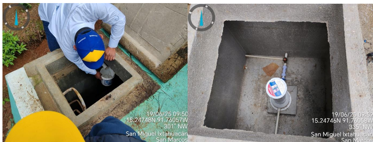
Aforo en tanque de distribución e instalación de hipoclorador (no está en funcionamiento)
