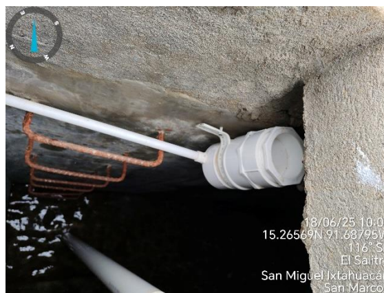
Vista del bajo nivel de agua, y de la ausencia de cloración activa en el sistema.
