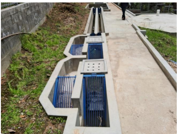
Vista de los elementos canal de rejillas y desarenador.
