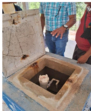
Vista del equipo de cloración, instalado en el tanque de distribución.
