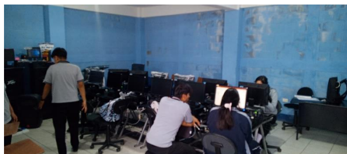
Área de laboratorio computación (humedad muros)
