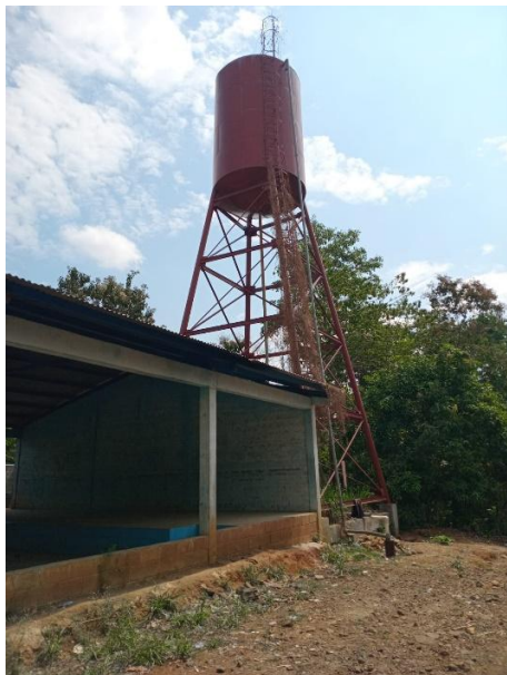
Vista del tanque elevado
