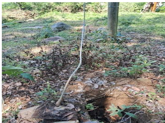
Anclaje de poste que fue derribado por el viento.
