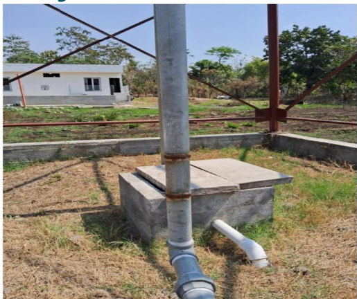
Tubería de impulsión
