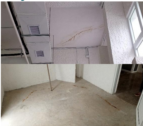
Fisura en losa y rastro de goteo
