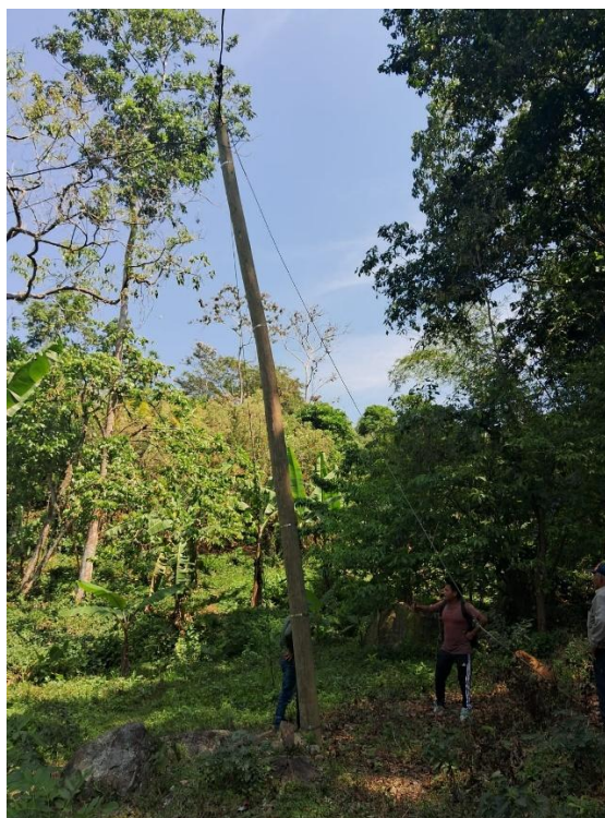
Poste en la línea de distribución de baja tensión afectado por la caída de un árbol
