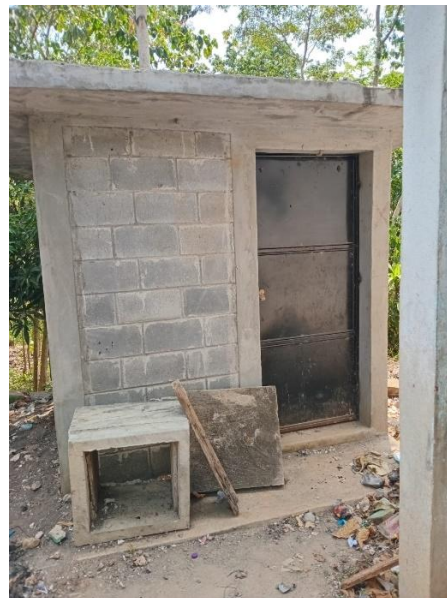
Caseta de control
