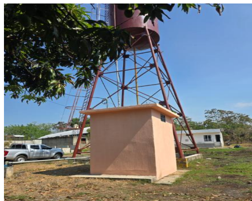
Caseta de controles
