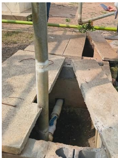
Caja de válvulas
