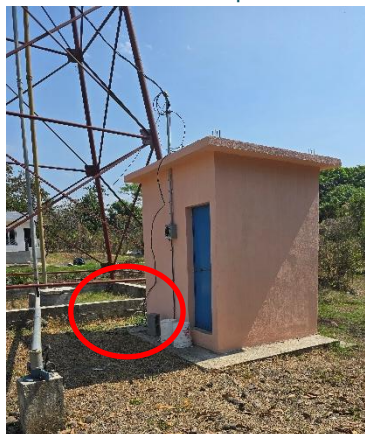
Cables de alta tensión expuestos.
