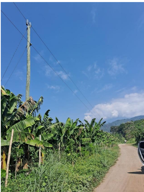
Línea de conducción de media tensión (según el nuevo trazo)
