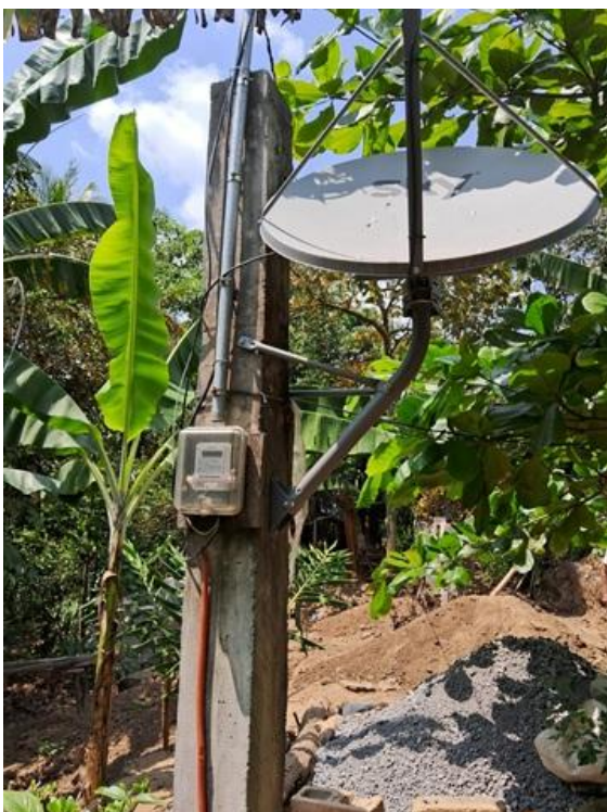
Poste con una conexión intradomiciliar.
