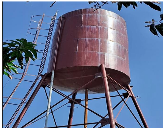
Depósito de Distribución
