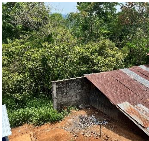
Falta de Muro perimetral, espacio para quemar basura.
