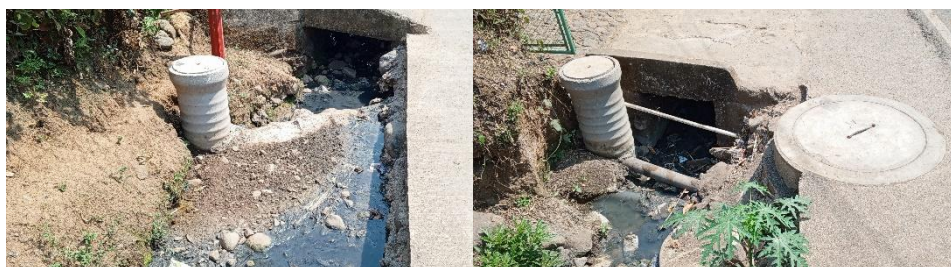
Conexiones prediales y pozo de visita
