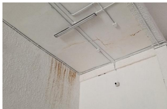
Rastro de filtraciones en losa y muro
