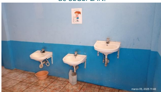
Fugas de agua en instalación hidráulica de lavamanos de baños en la escuela.
